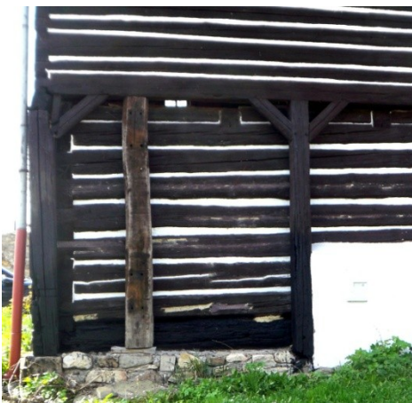
Abb. B-73 ungesicherte Abstützung
