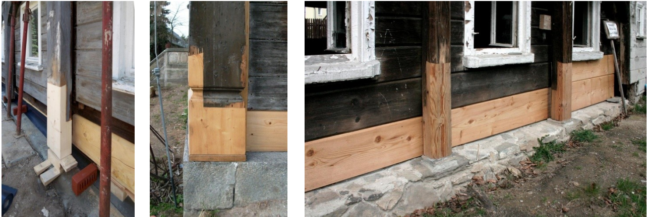
Abb. B-75 angeblatteter Ständerfuß bei gleichzeitiger Wiederherstellung des Klinkersockels / Abb. B-76 Eichenklotz unter einem erneuerten Eckständerfuß / Abb. B-77 neue Ständerfüße auf erhabenen Steinplatten des wiederhergestellten Natursteinsockelmauerwerkes
